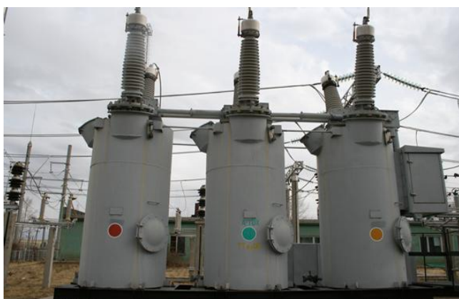
9 тонн тос бүхий 110 кВ-ын тосон таслуур
